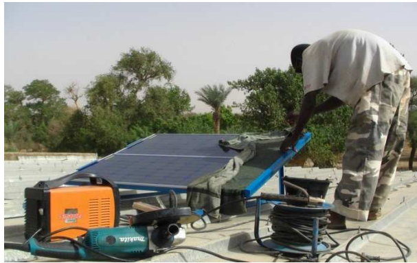
Die Solarpaneele werden auf dem Schuldach in einem Metallrahmen montiert und fest verschweißt
